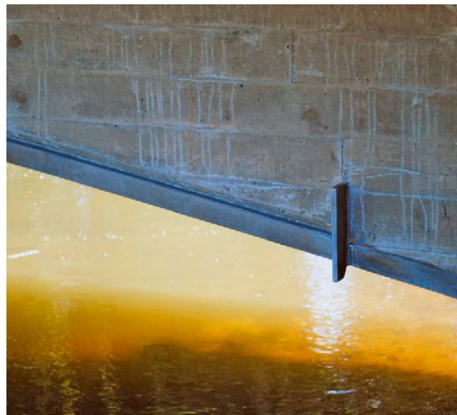
Im eingebauten Zustand ist nur noch der Flansch des feuerverzinkten, mit Verbunddübeln versehenen Walzträgers zu sehen.
