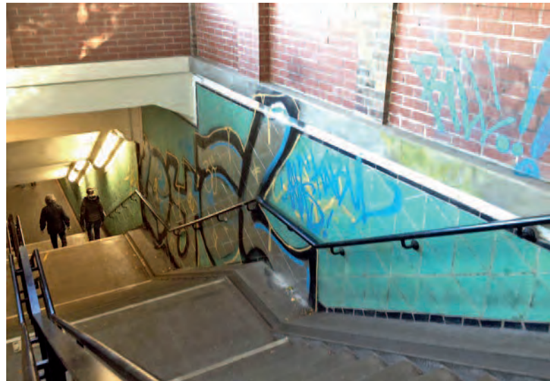
▲ Vandalismus am Eingang Süd kurz nach der Übergabe
