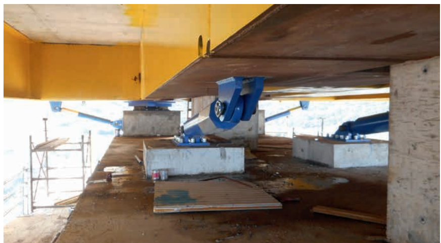
Einbausituation auf einem der beiden Brückenpfeiler: vorn Mitte und rechts zwei Hydraulikdämpfer in Querrichtung, links dahinter eines von vier Gleitpendellagern, dahinter außen zwei Längs-Hydraulikdämpfer.
